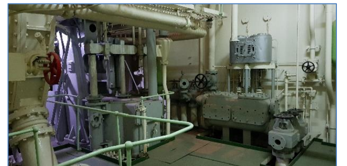
Links op foto: zicht op condensor en de T.E.M.
