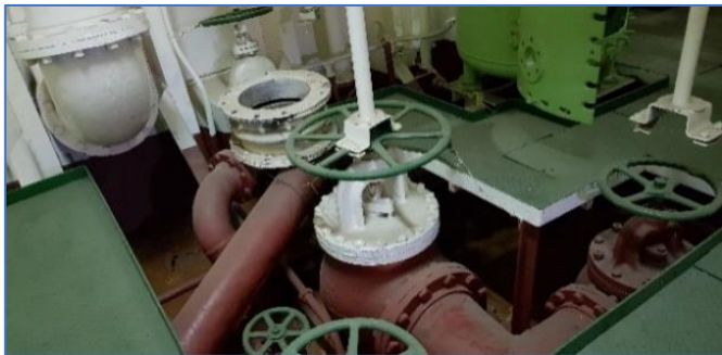
Koelwaterinlaat en Verdamper
